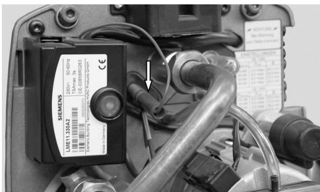
Abb. 22: Ionisationskabel mit Stecker
