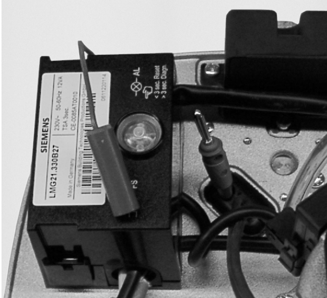
Abb. 21: Zum Anschluss des Multimeters wird die Steckverbindung aufgetrennt.
