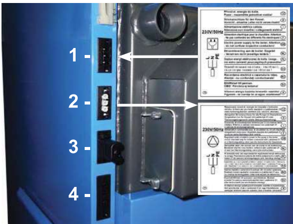
Steckverbindungen in der rechten Kesselabdeckung
