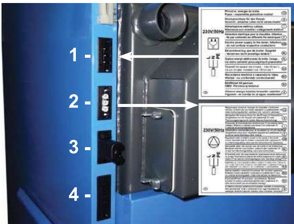
Steckverbindungen in der rechten Kesselabdeckung
